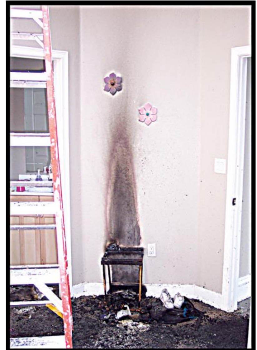
FIGURA 6.3.20.2.1(d) Marca de cono invertido creado por un derrumbamiento.
