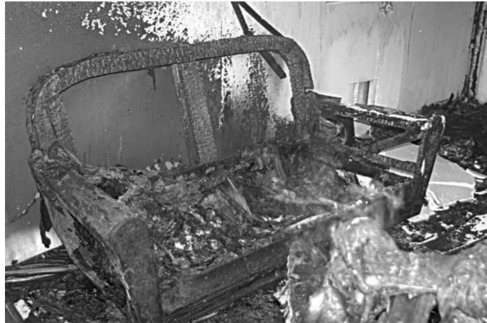
FIGURA 6.3.9.2 Mayor pérdida de masa en el brazo derecho de este sillón para dos personas que en el brazo izquierdo.
