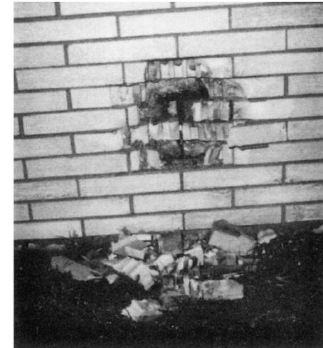
FIGURA 6.3.15.5 Daños en una Pared de Ladrillo Visto Causados por la Dilatación Térmica en los Apoyos de una Viga.
