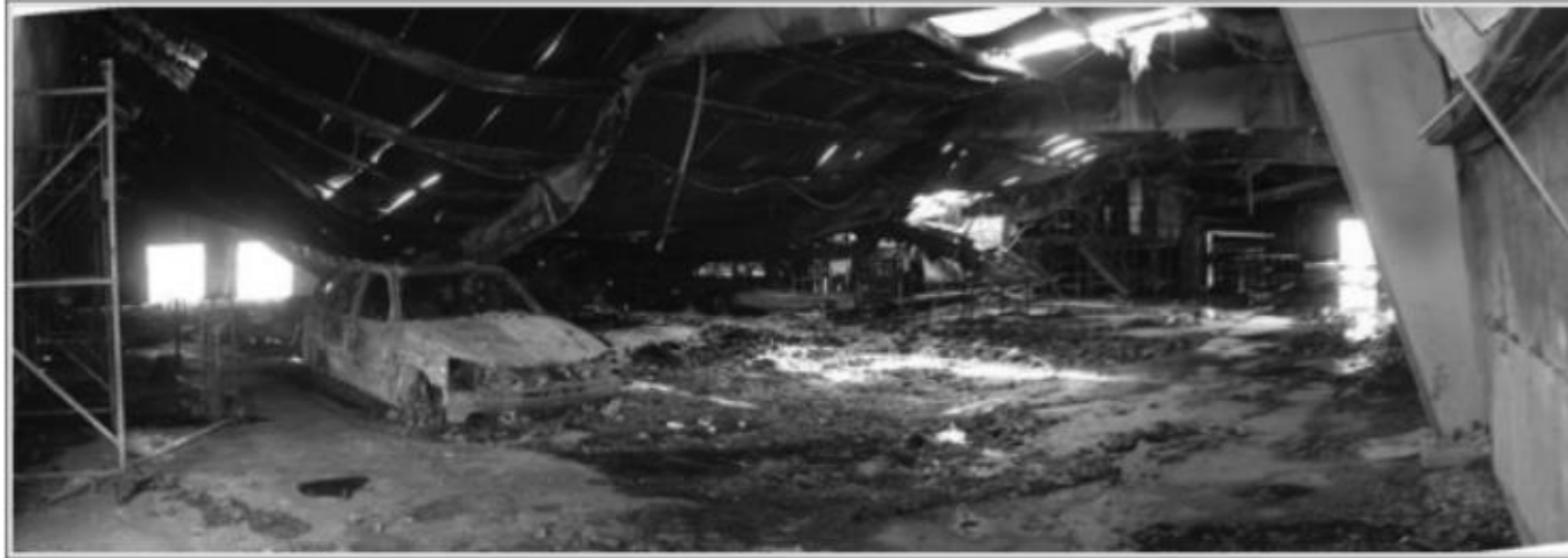
FIGURA 6.3.15.3 Vigas de acero deformadas por calor baja carga.
