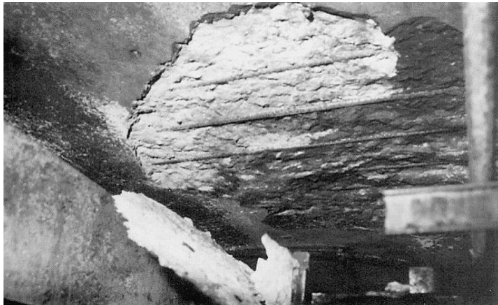
FIGURA 6.3.14.3.3 Exfoliado en un Techo.
